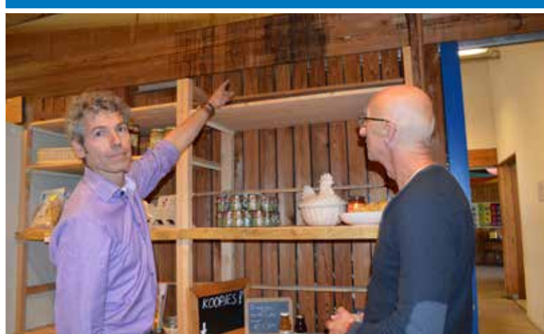
Geert Naber en bestuurslid Harry van Velsen inspecteren de lekkage
