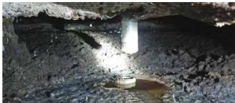
Vorige week brak een rioolpijp door de bodemdaling....
