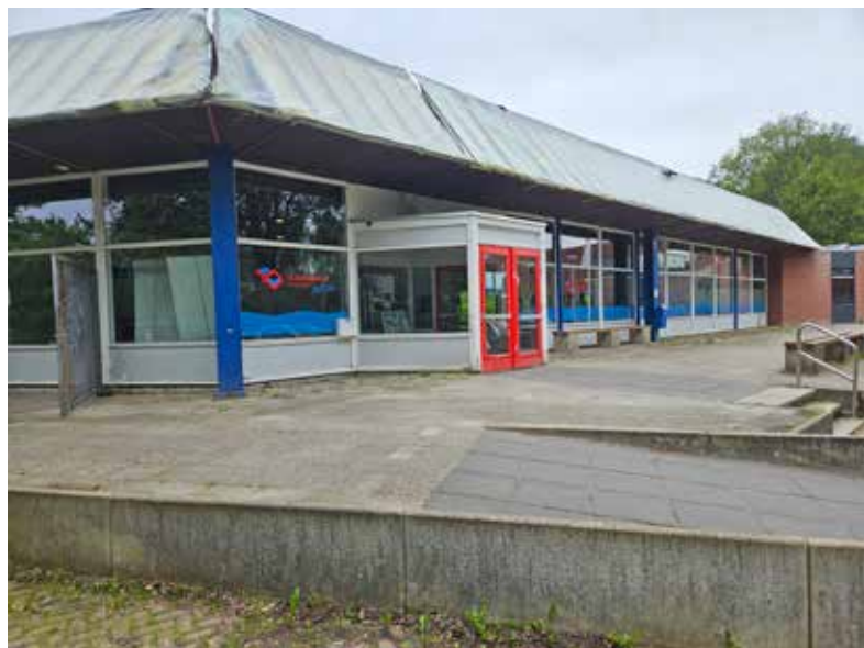
Het gebouw met kapot dak.
